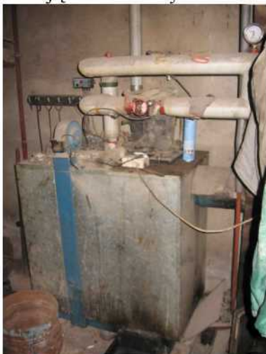
3. Istniejące źródło wytwarzania ciepłej wody użytkowej
