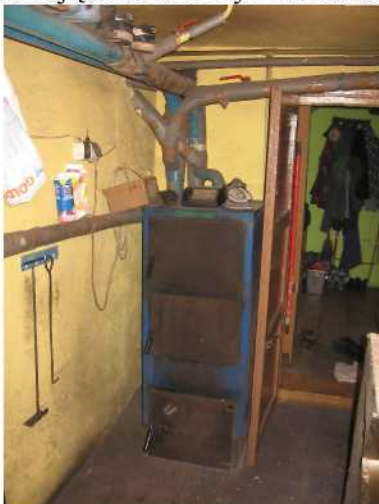
3. Istniejące źródło wytwarzania ciepłej wody użytkowej
