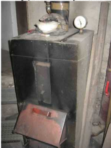
3. Istniejące źródło wytwarzania ciepłej wody użytkowej
